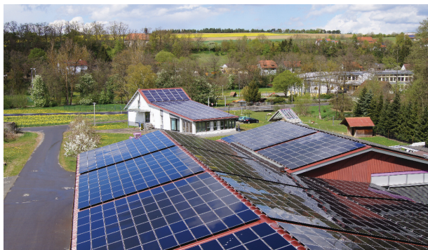
Die beiden großflächigen Photovoltaik-Anlagen der Schreinerei und des Mietshauses
